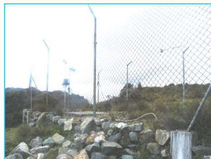
Estado del cerramiento de protección de la estación hidrometeorológica.
