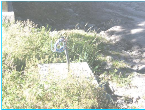
Base sin el respectivo armario de control localizado en Soldados
