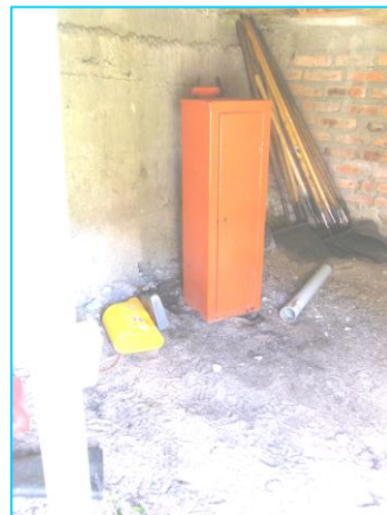
Armario de control de Soldados depositado en bodega
