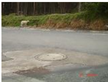
Válvula localizada en la vía Ochoa León-Ricaurte
