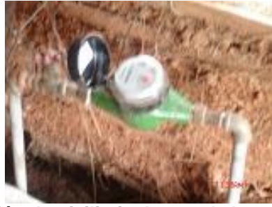
Conexión domiciliaria de uno de los usuarios
