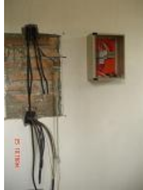
Situación interna en caseta de control
