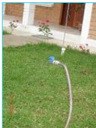
Conexión domiciliaria inconclusa
