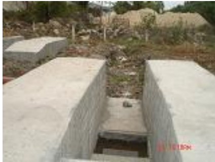
Situación de una de las rampas para el lavado de vehículos
