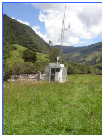
FOTO N° 17.- Estación Hidrometereológica en sector de Pucán
