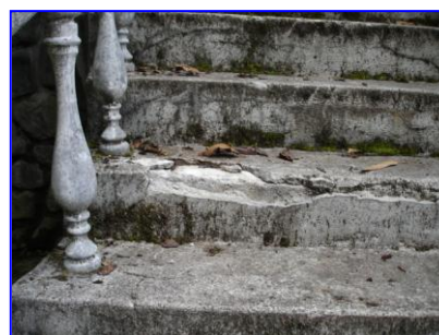
Estado de gradas de casa de Mazán
