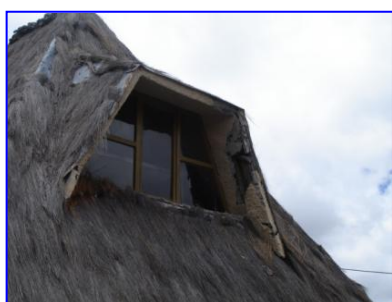
Estado de cubierta del Refugio de Toreadora
